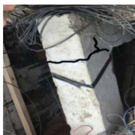
抗滑支挡结构破坏
