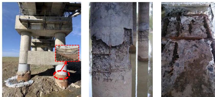
图 1 冻融、腐蚀环境下混凝土外观劣化
