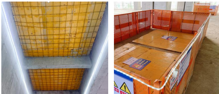
图 7 洞口钢筋网片防护
